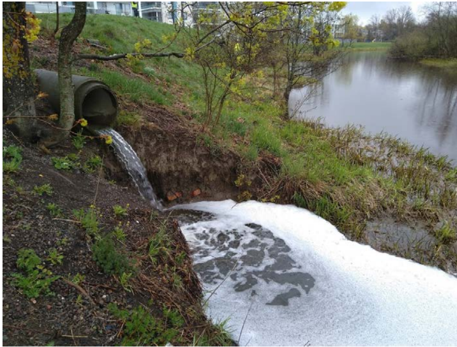
Kuva 9.1. Kaupunkialueella jokien vaahtoamisesta tulee ajoittain kyselyjä. Se on virtavesissä tavallista sateen jälkeen. Kuvassa jokipenkkää sortanut hulevesirumpu tuo vesiä pientalovaltaiselta asuntoalueelta Keravanjokeen. (kuva: VHVSY/HV)
